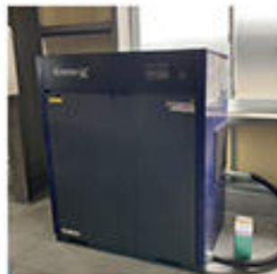
エアコンプレッサー
