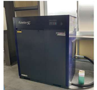
エアコンプレッサー
